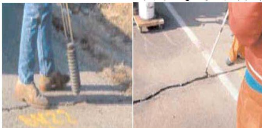
شکل 2: تزریق هوای گرم با فشار زیاد به محل ترک، پر کردن ترک با وسیله درزگیر
